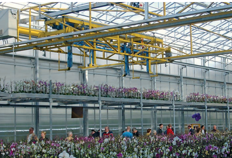
Dwupoziomowa suwnica stropowa
